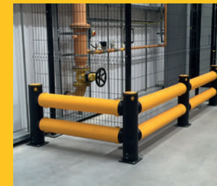
Barriera iFlex Traffic con doppio respingente a protezione del sistema sprinkler in un'azienda alimentare.
